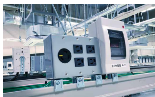
200V電源コンセント口
